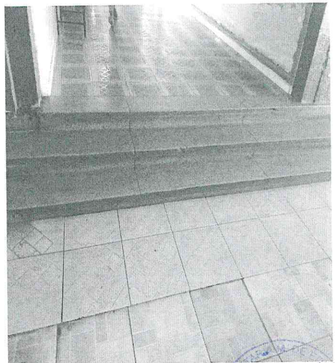
4. Degraus no corredor – sem rampa de acessibilidade.
