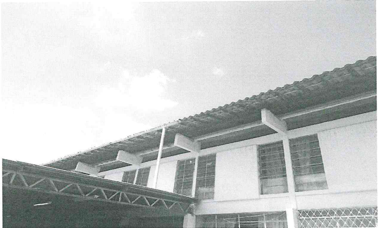
5. Telhado – telhas deslocadas e/ou quebradas na extensão do telhado. Deslocamento do rufo.
