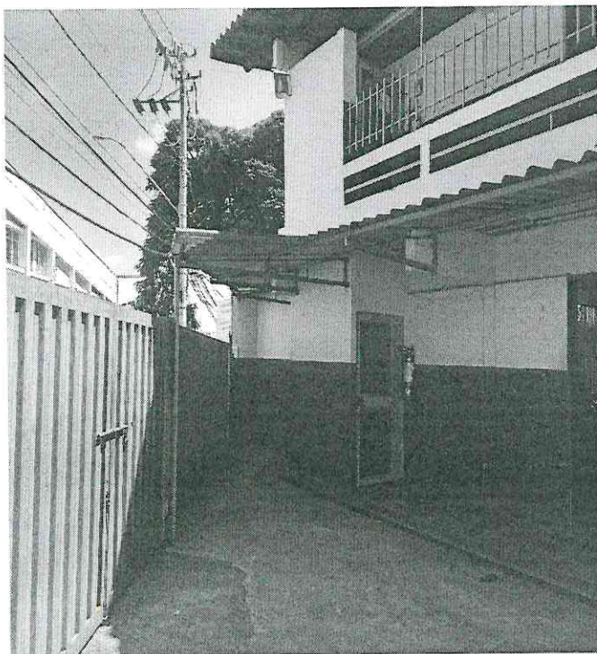
3. Entrada principal sem telhado de ligação com o prédio.
