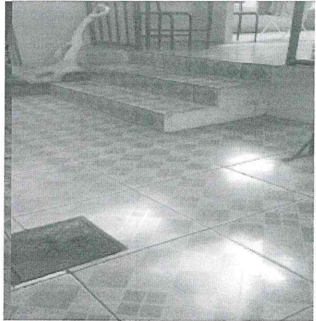
2. Piso escorregadio e com afundamento.
