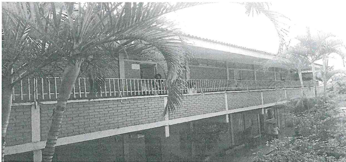
5. Falta de calha para escoamento da água pluvial.
