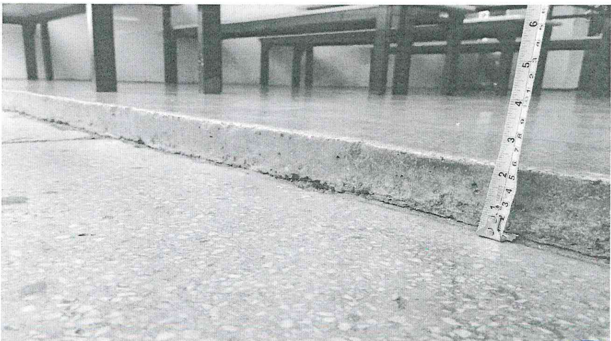
10. Desnível no refeitório.
