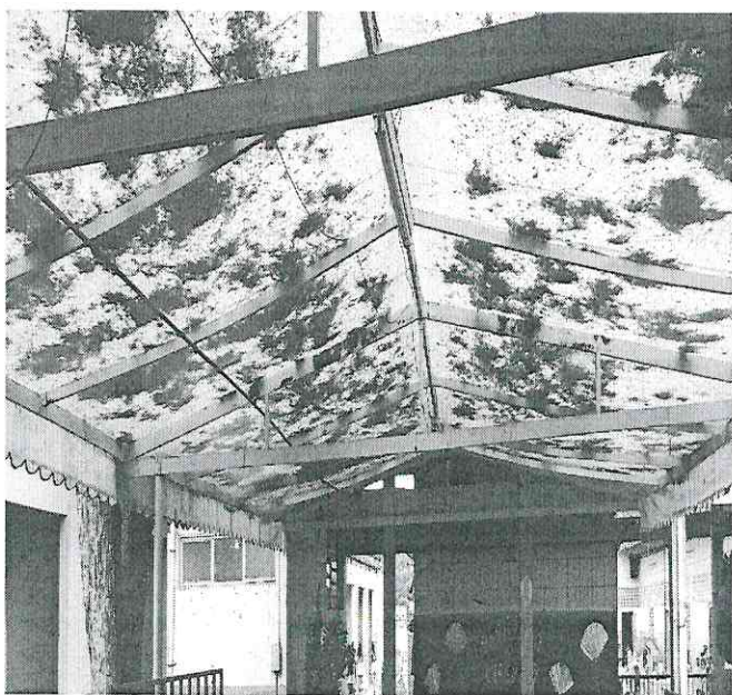
6. Área do pátio - toldo a ser substituído.
