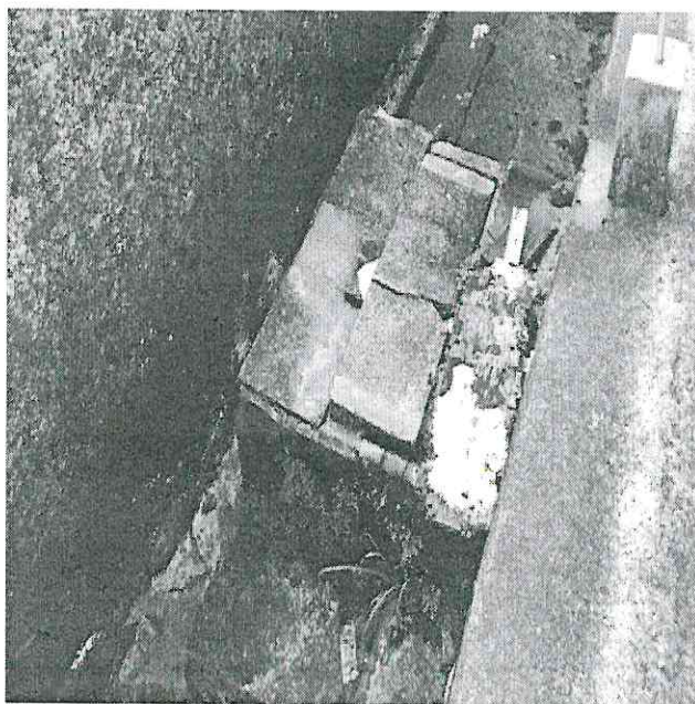
3. Caixa de gordura com vazão insuficiente.
