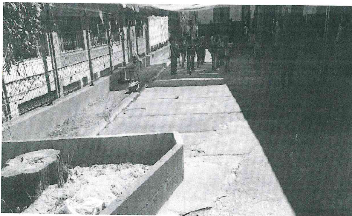
5. Canaletas abertas – reformar.
