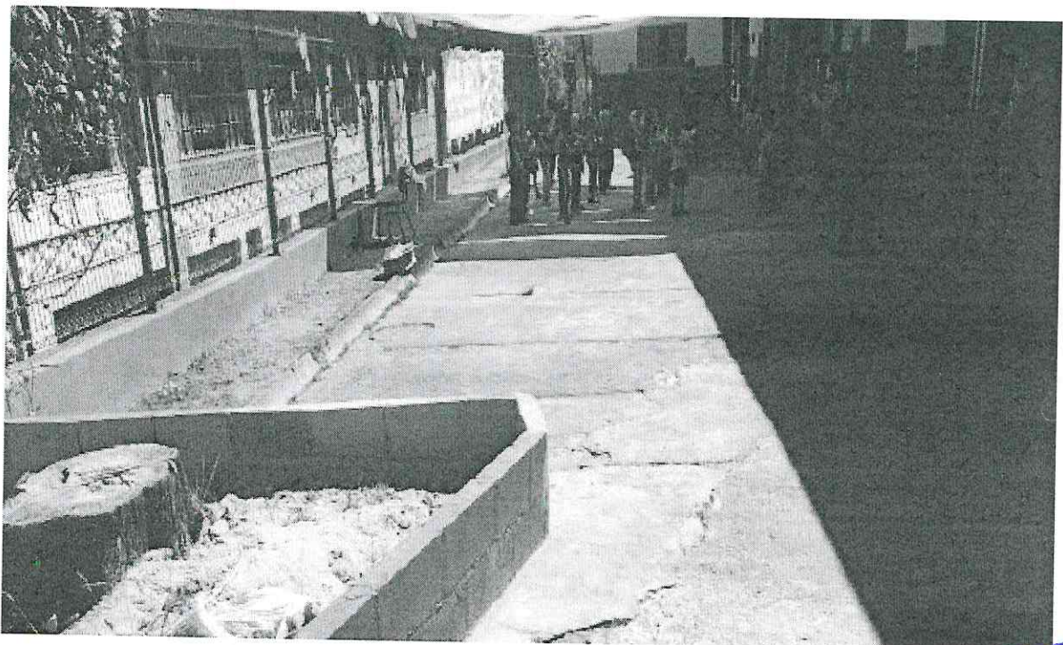
5. Canaletas abertas – reformar.
