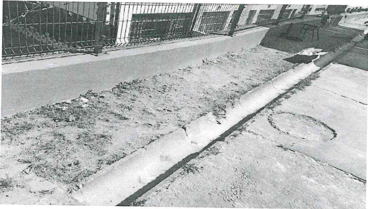
4. Canaletas abertas – reformar.
