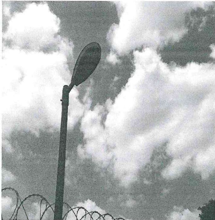
4. Rever fiação elétrica do poste de iluminação do estacionamento.
