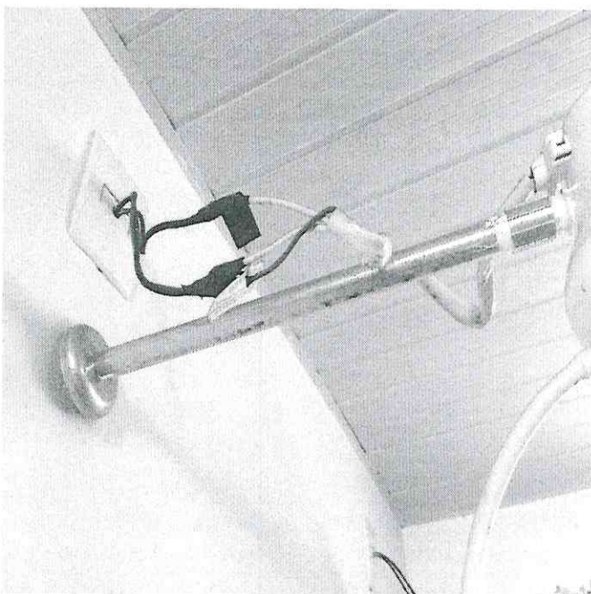
6. Fiação elétrica exposta – chuveiros.
