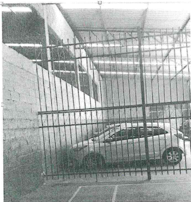
4. Demolição de parte de alvenaria, retirada da grade e construção da arquibancada
