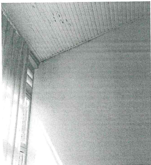
1. Forro com infiltração oriunda do telhado.
