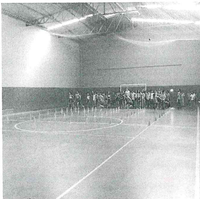
6. Demolição de parte da alvenaria, instalação de grades e pintura do piso.
