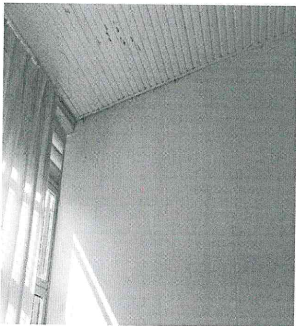
1. Forro com infiltração oriunda do telhado.
