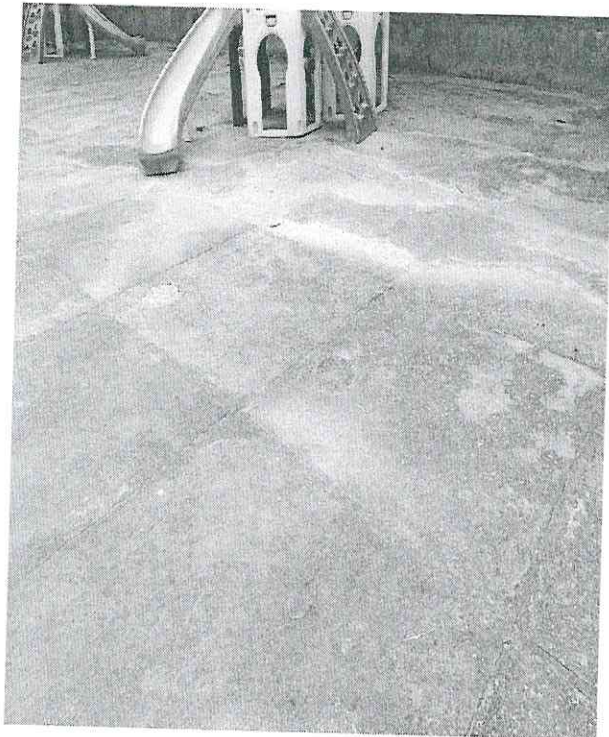
2. Piso irregular da área do parquinho.
