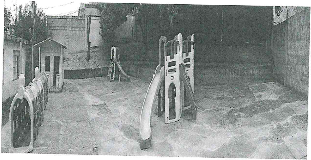
1. Área do parquinho – piso de concreto e desnivelado.
