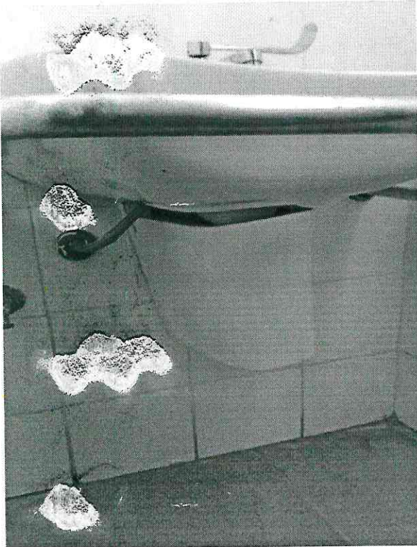
5. Pia do banheiro manchada e danificada.
