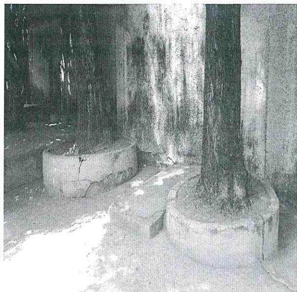
7. Piso externo - nivelar espaço retirando os buracos.
