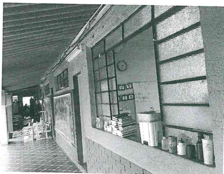
Figura 4: Fiação exposta ao entorno da escola
