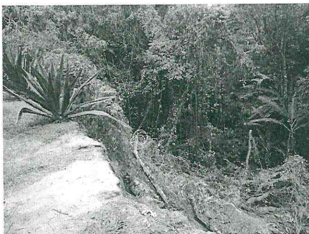
Cerca no solo erodido.
