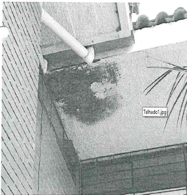
Figura 2: Infiltração por vazamento do telhados
