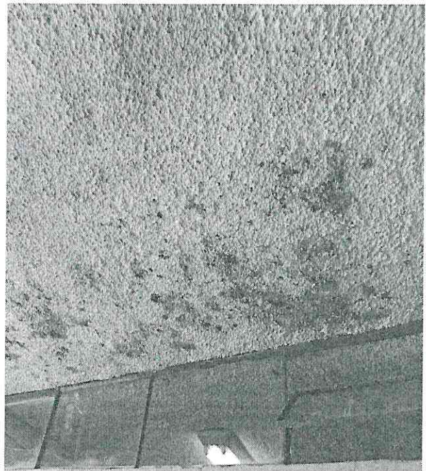
Figura 3: Infiltração por vazamento do telhado
