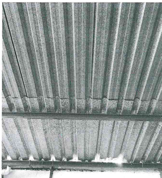
6. Vazamento entre as telhas.
