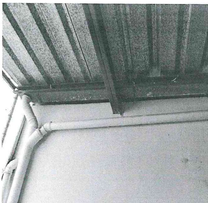
7. Somente dois pontos de vazão para água.
