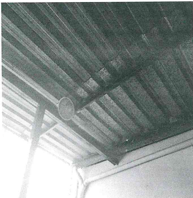
11. Iluminação da quadra – insuficiente.
