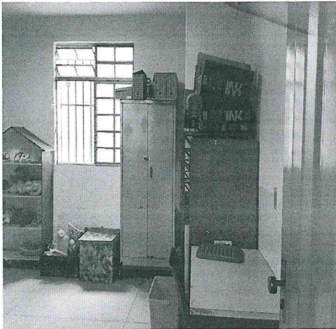
1. Brinquedoteca – umidade nas paredes.
