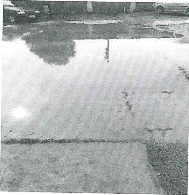
1. Piso do estacionamento – acúmulo de água pluvial.
