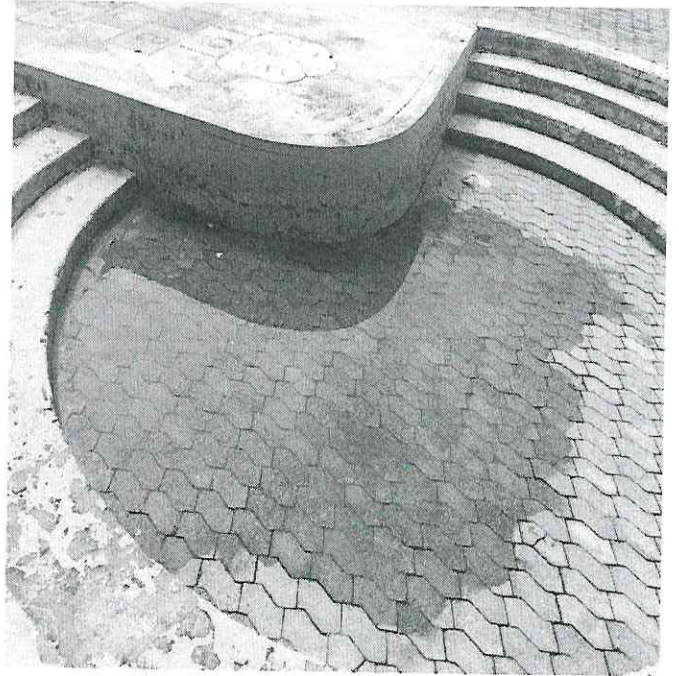
2. Piso do teatro da arena – acúmulo de água pluvial.
