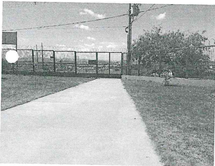
Figura 6: Entrada da escola necessita de cobertura.
