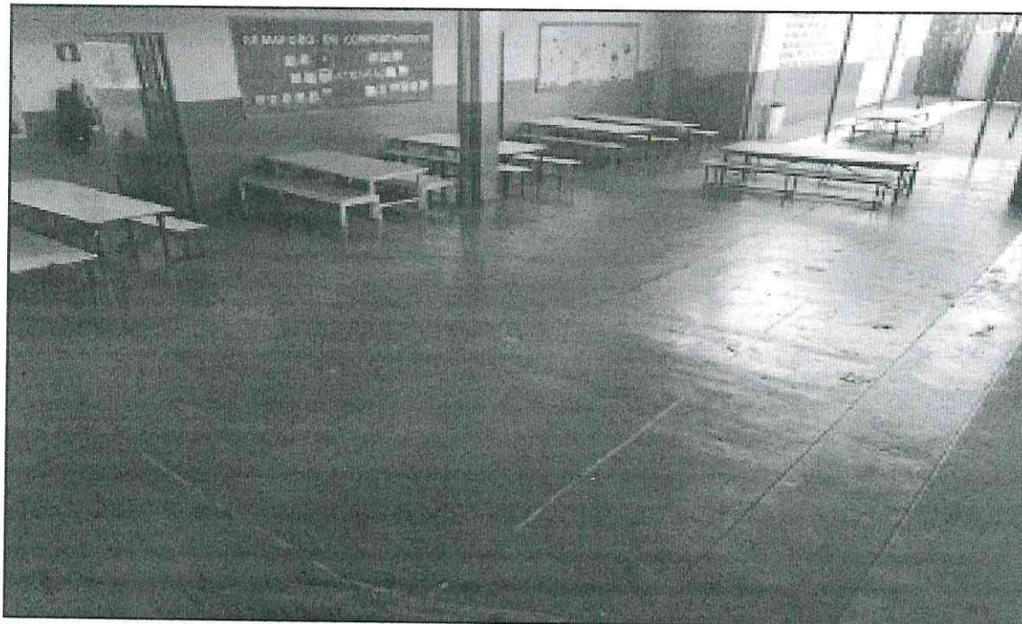
1. Piso do refeitório/pátio principal – escorregadio.
