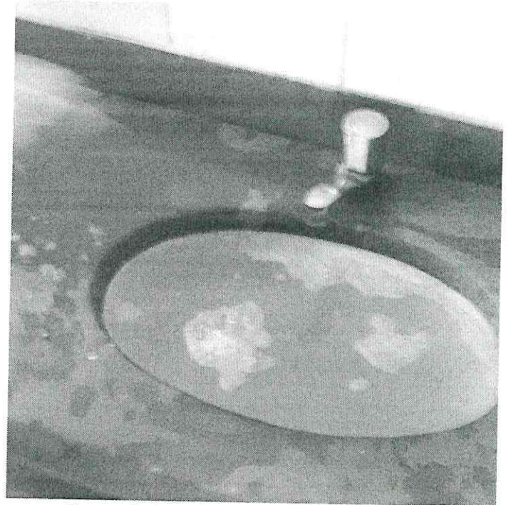
Figura 2: instalações hidráulicas danificadas
