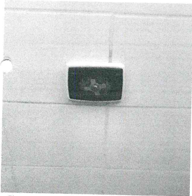
Figura 1: Válvulas de descargas não funcionam
