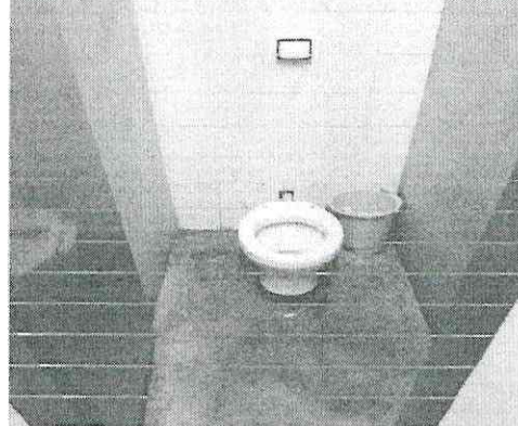
Figura 2: Vaso sanitário e pias desgastados devido ao tempo de uso.
