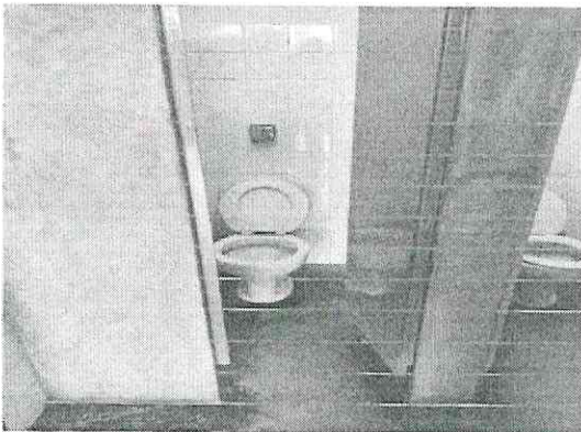
Figura 1: Vaso sanitário e pias desgastados devido ao tempo de uso.
