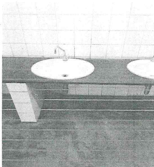
Figura 3: Pia do banheiro dos alunos com altura desproporcional.
