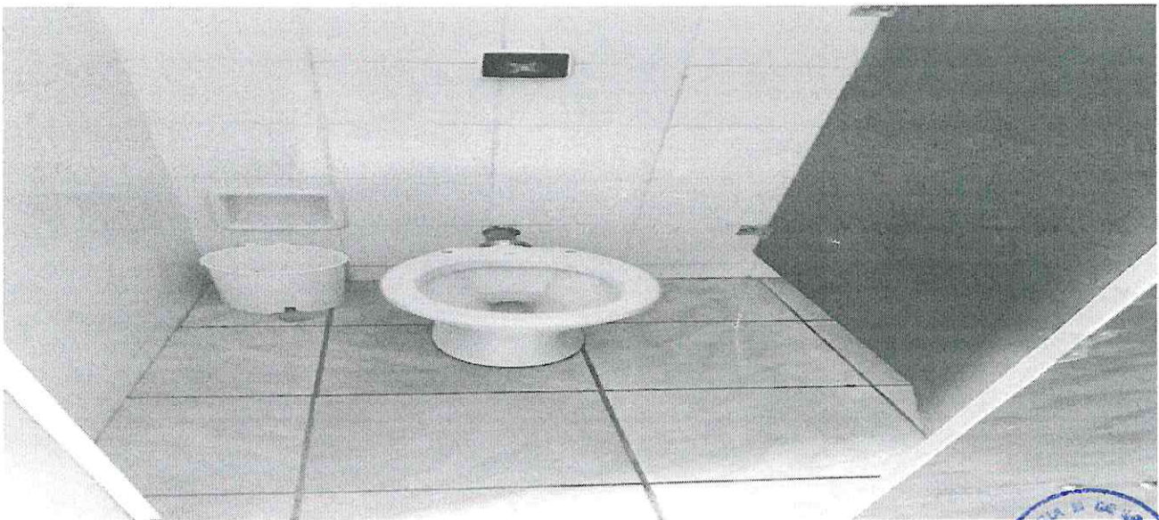
2. Banheiro – falta válvula de descarga e outros reparos.
