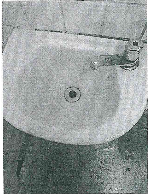
Figura 2: Pia entupida por problemas da rede pluvial. (2)
