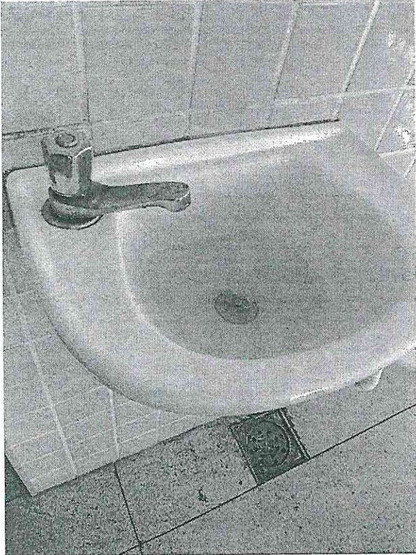
Figura 1: Pia entupida por problemas da rede pluvial.
