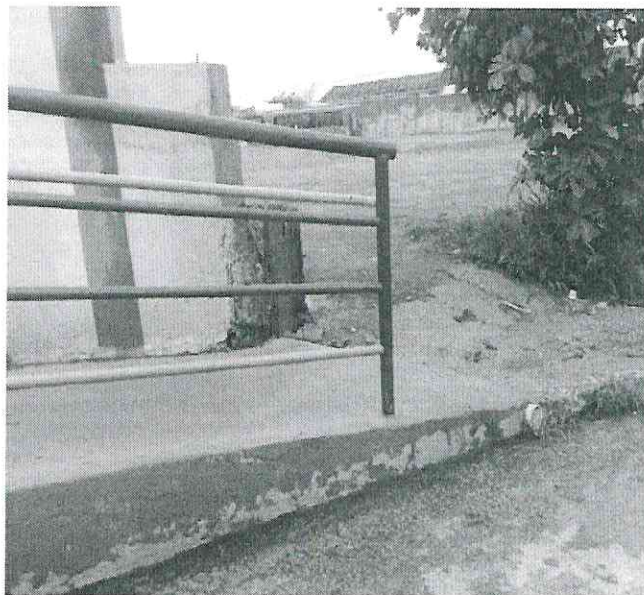
2. Rampa de acesso – degrau.
