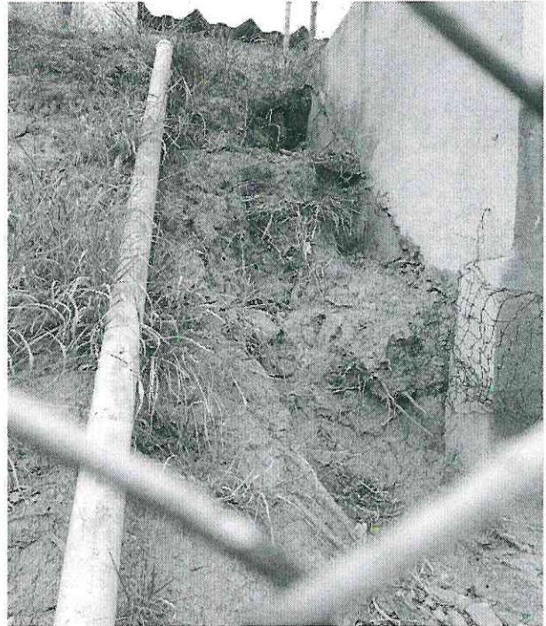
10. Erosão ao lado da rampa.
