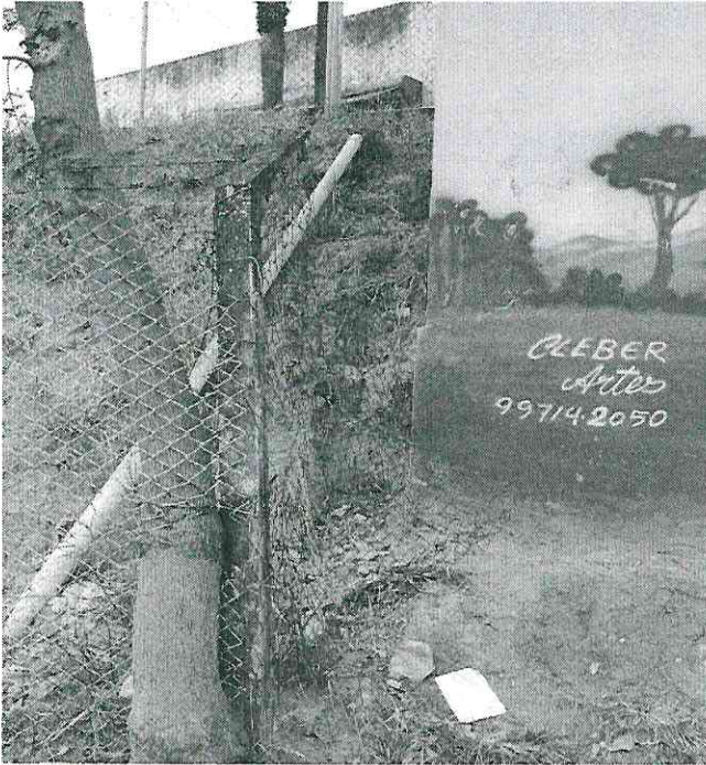
9. Local que apresenta problema com a drenagem da água pluvial.
