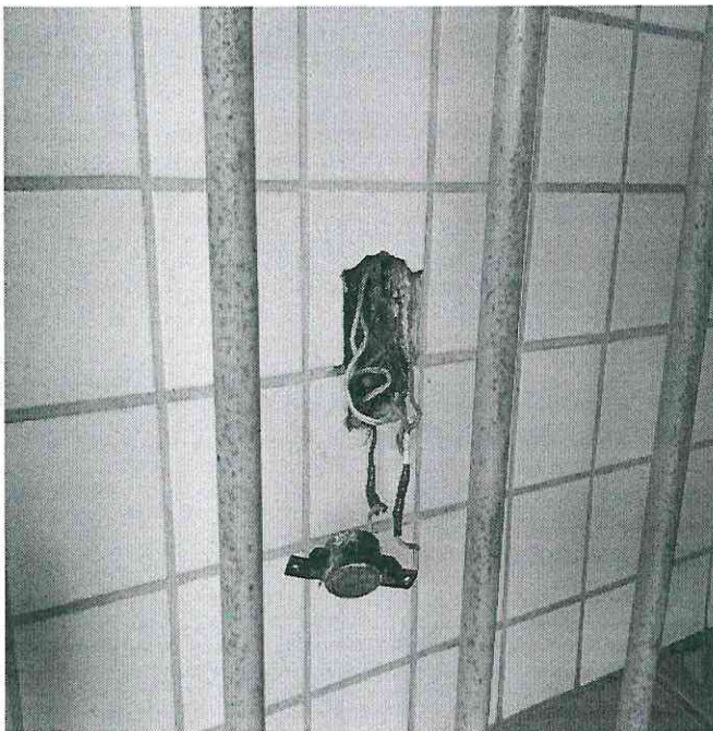
3. Tomadas em mau estado.
