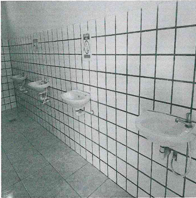
5. Pias do banheiro sem torneira.
