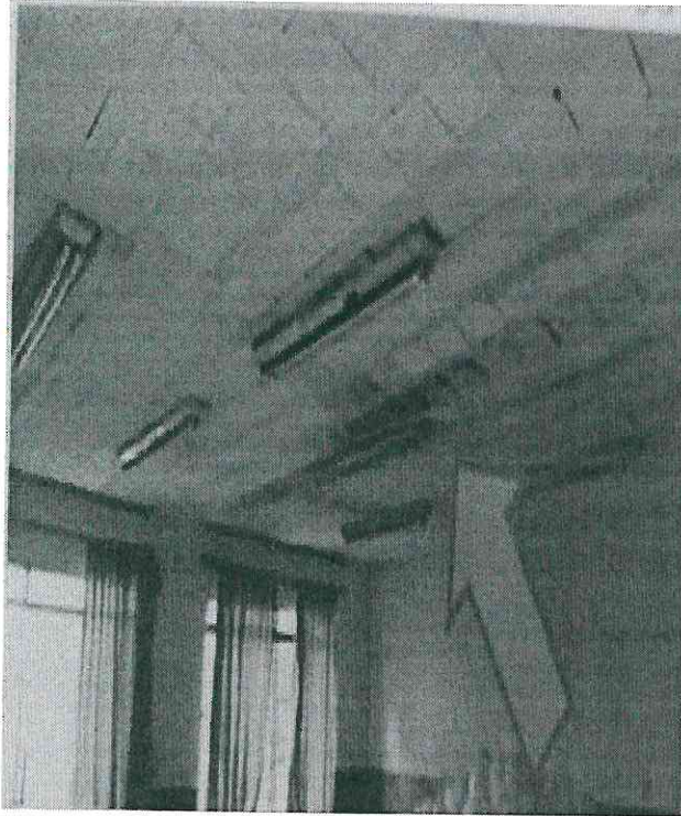
1. Sala interditada – manchas e mofo no teto.
