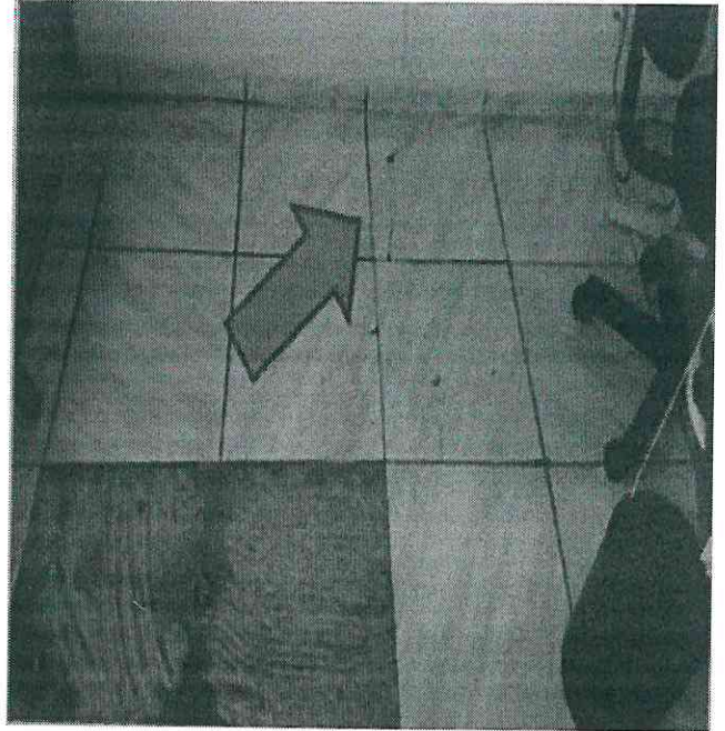
5. Piso da secretaria – desprendimento de cerâmicas.
