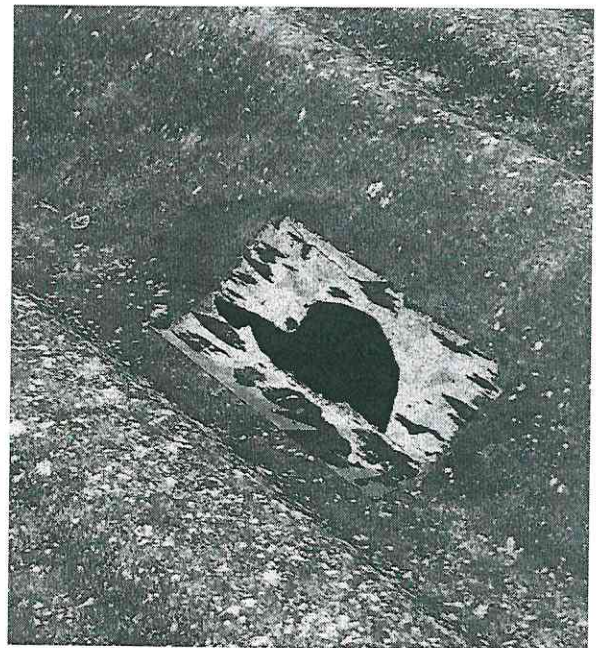
4. Telhado – buracos e remendos em telhas.
