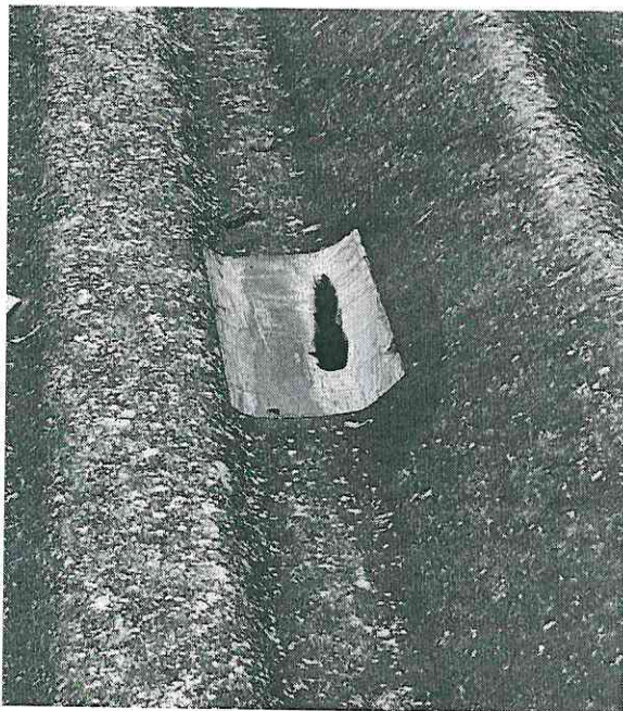
3. Telhado – buracos e remendos em telhas.
