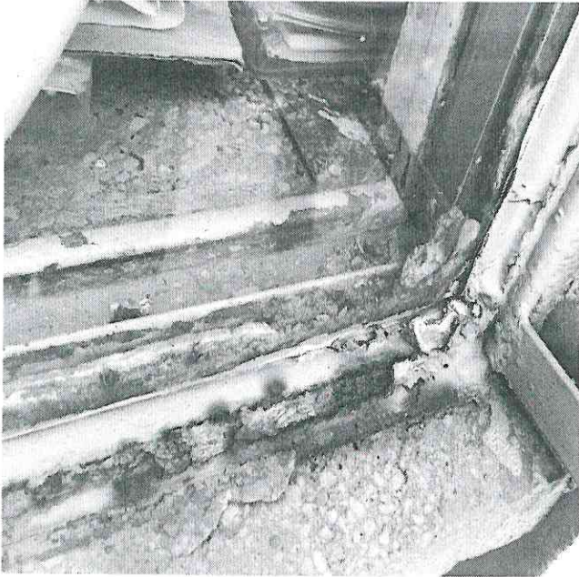
3. Janelas – ferrugem e corrosões.
