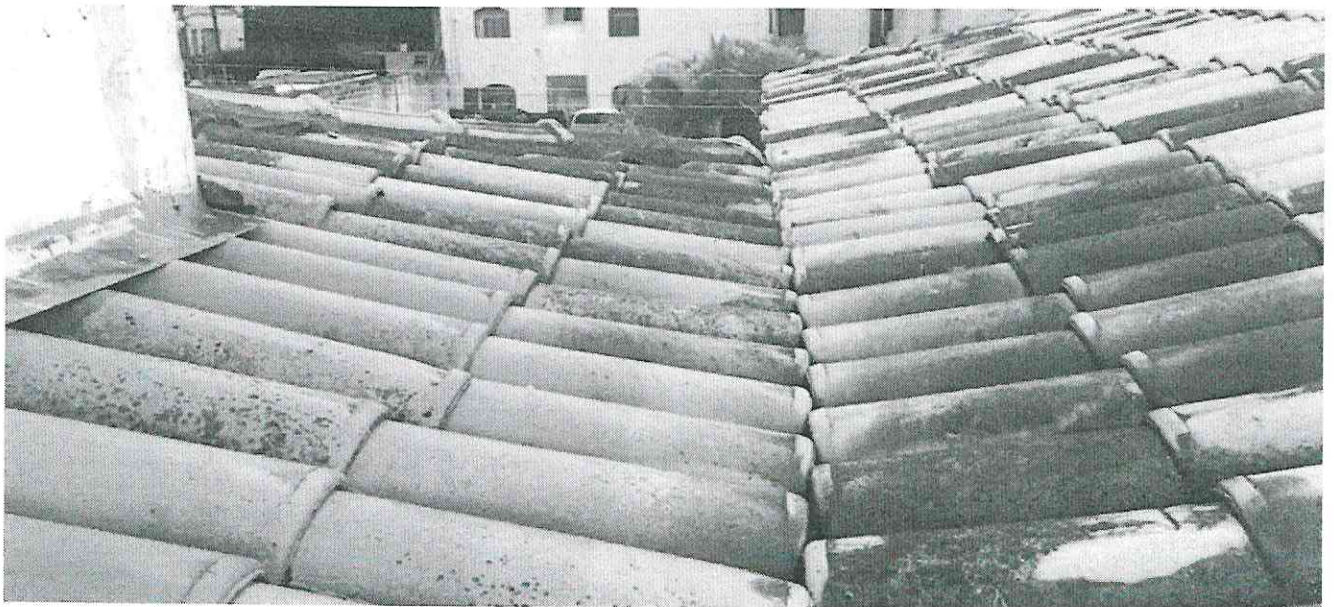
2. Telhado – telhas deslocadas e mofadas - infiltração de água pluvial.
