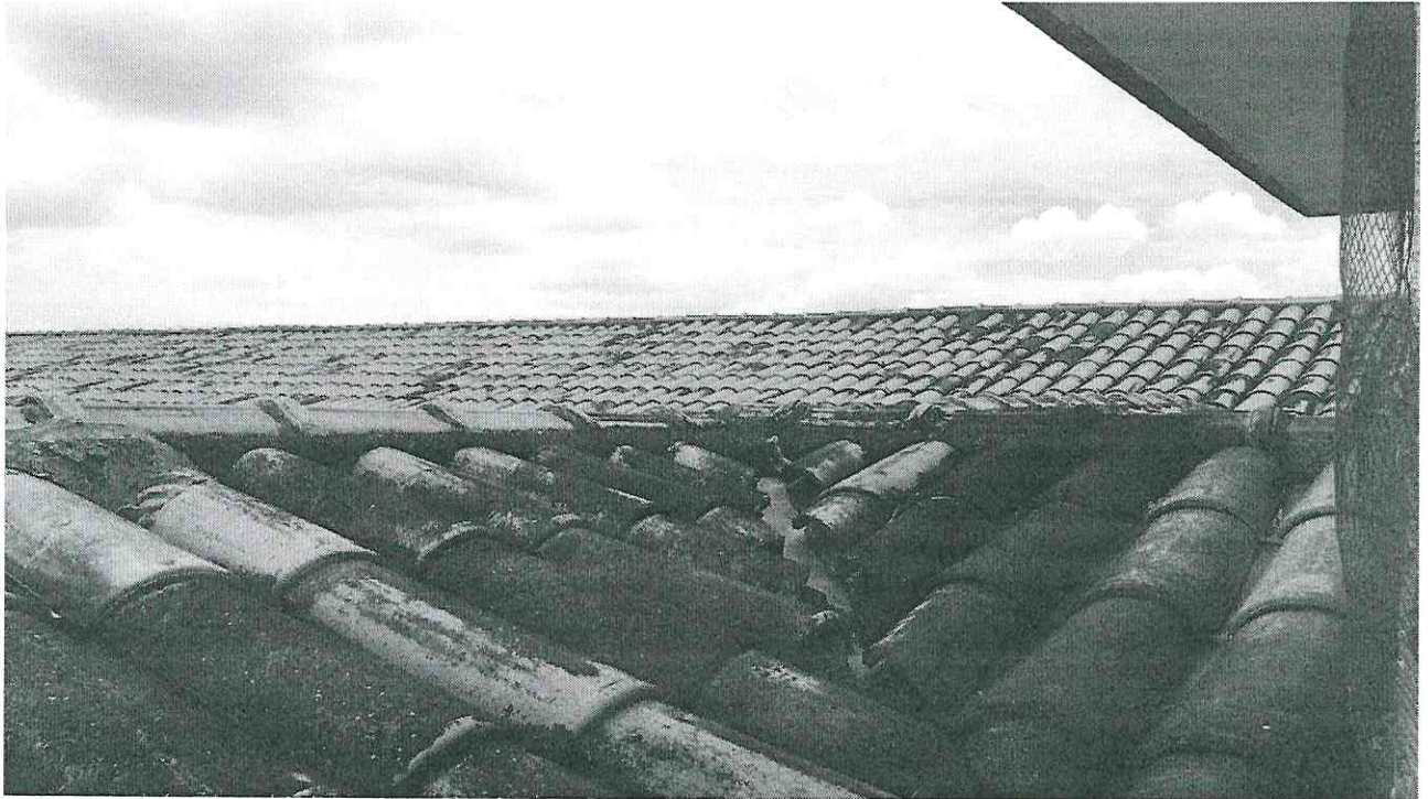
1. Telhado – telhas deslocadas e mofadas - infiltração de água pluvial.
