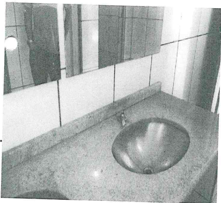
3. Ausência de torneira no lavatório do banheiro.
