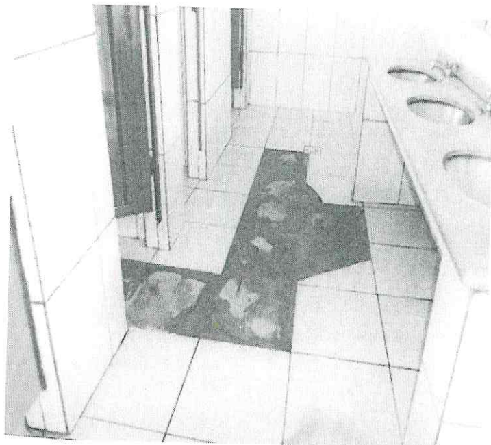
2. Desprendimento de ceramicas no piso.
