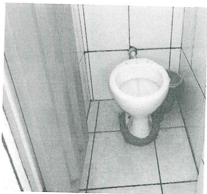
4. Remendos na base do vaso sanitário.
