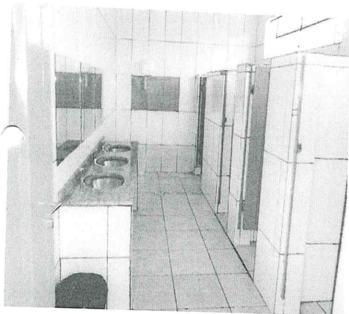
1. Banheiros – desprendimento de azulejos na parede.
