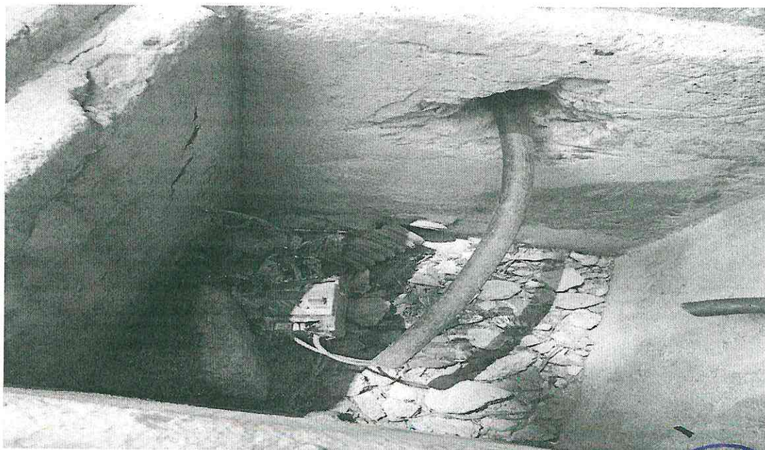
2. Fiação da escola exposta e comprometida
