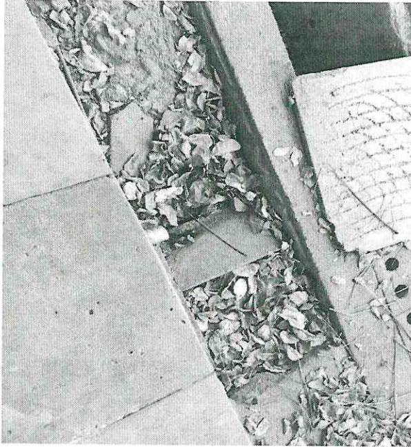
3. Calhas pluviais precisando de reparo
