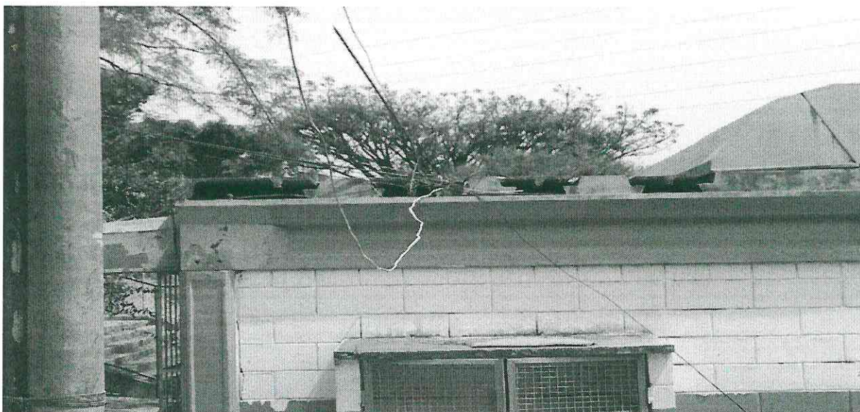
7. Telhado – telhas quebradas e infiltrações.
