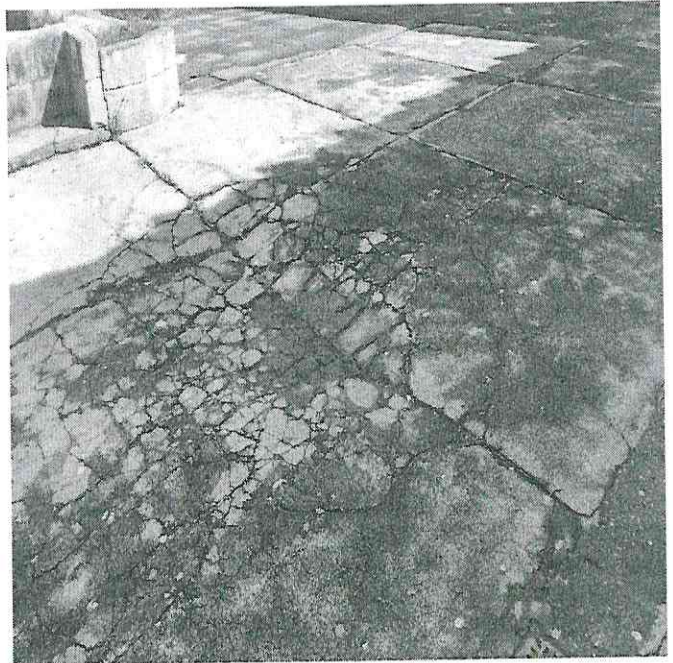
2. Piso do pátio – trincas.
