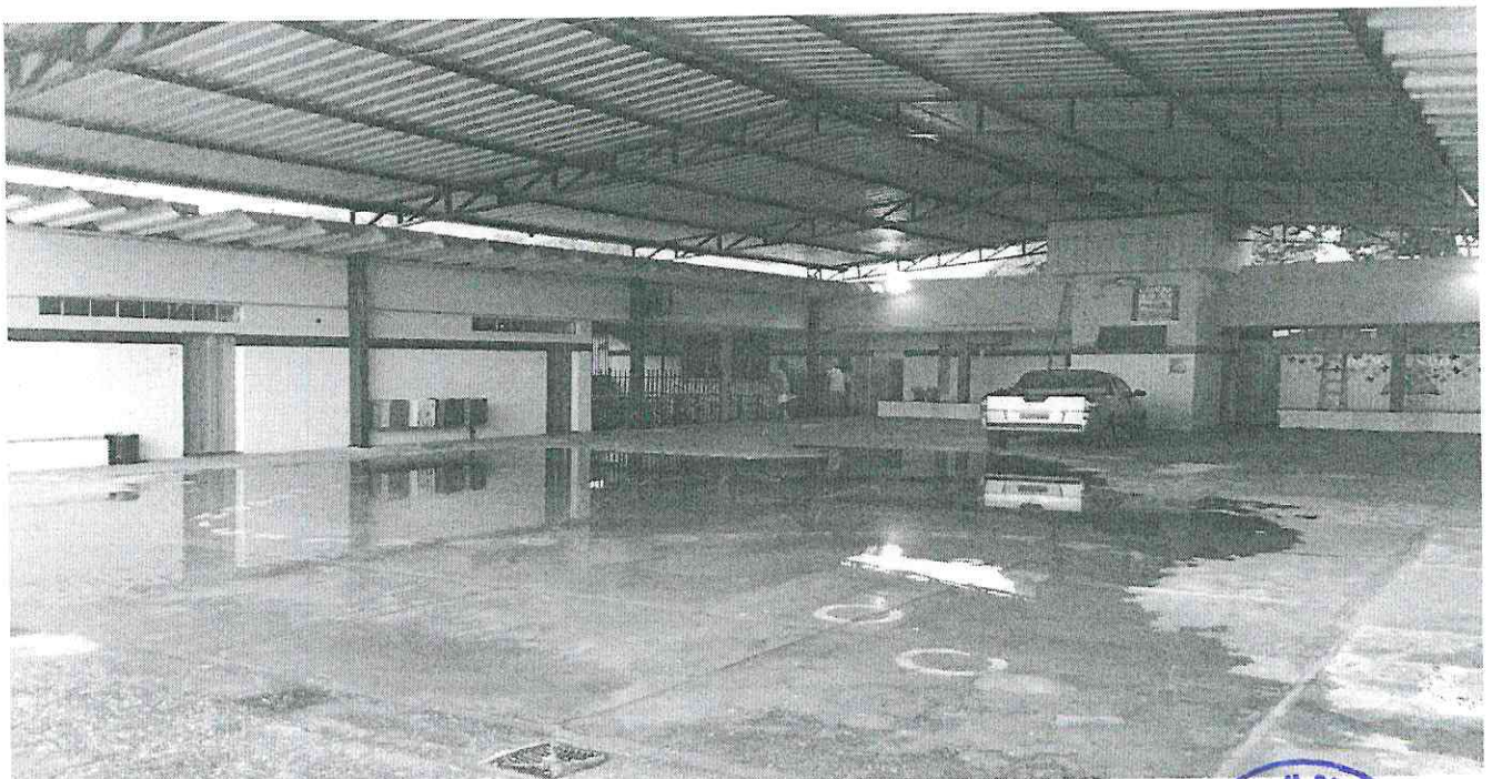
3. Piso do pátio – alagamento em períodos chuvosos.
