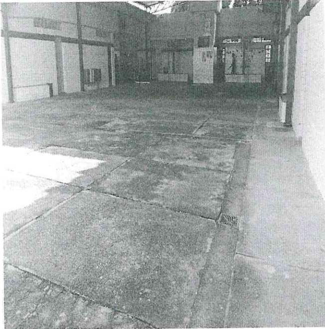
1. Piso do pátio – desnível.
