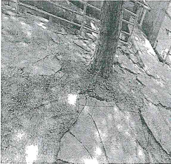
1. Vista do piso em concreto danificado.
