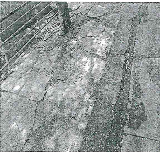
3. Vista do piso em concreto danificado.
