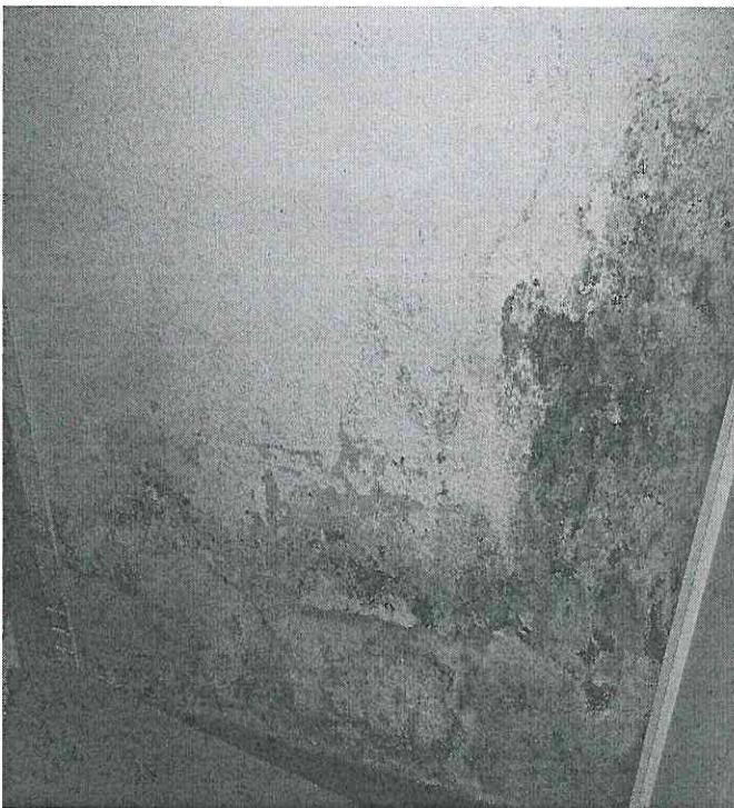
10. Parede da Ed. Infantil – mofo.
