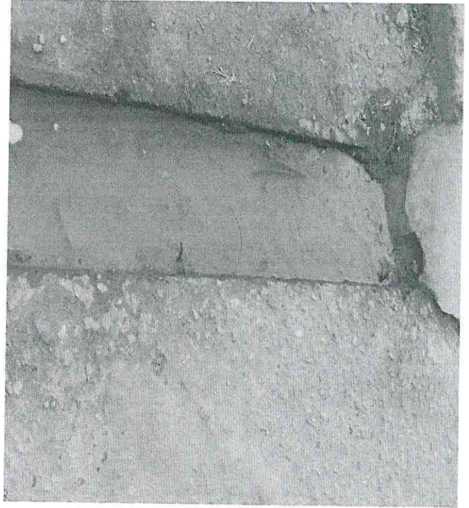
6. Rede pluvial – exposta e entupida.
