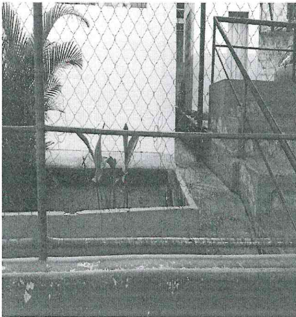
3. Alambrado da quadra – diversos pontos danificados.
