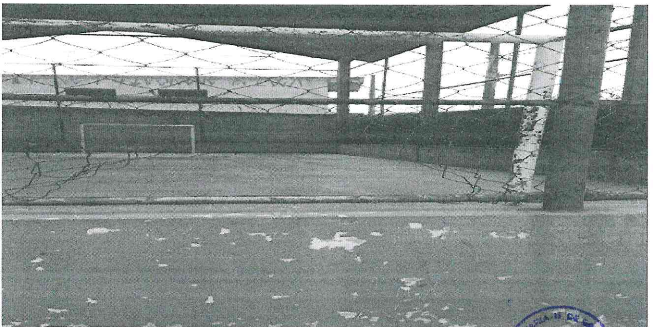
5. Alambrado da quadra – buracos e pontas.
