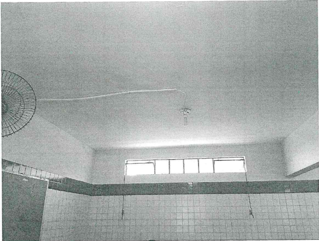
Figura 7: Infiltração na sala de aula.
