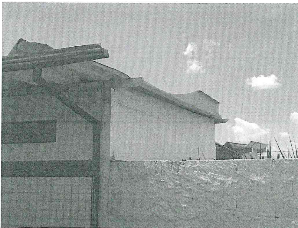
Figura 5: Parte da cobertura fraturada.
