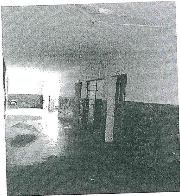
Figura 1: Teto do corredor com infiltração.
