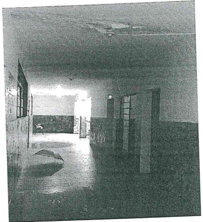
Figura 2: Teto do corredor com infiltração.(2)
