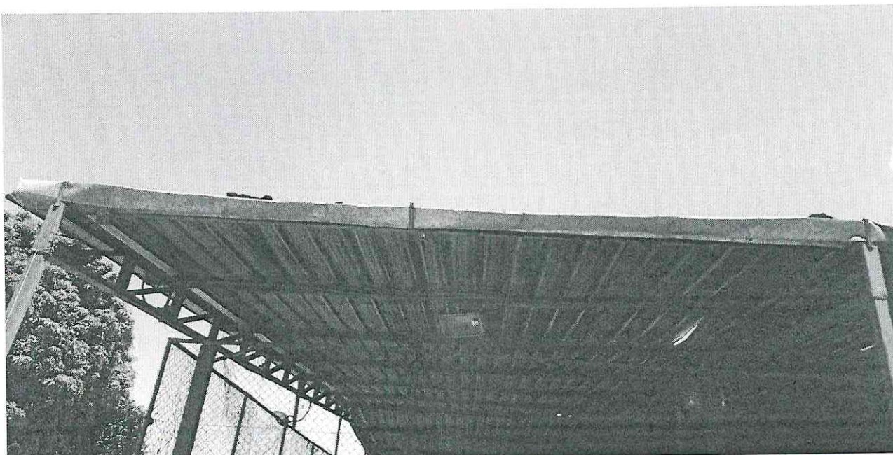
11. Telhado danificado e com diversos furos.
