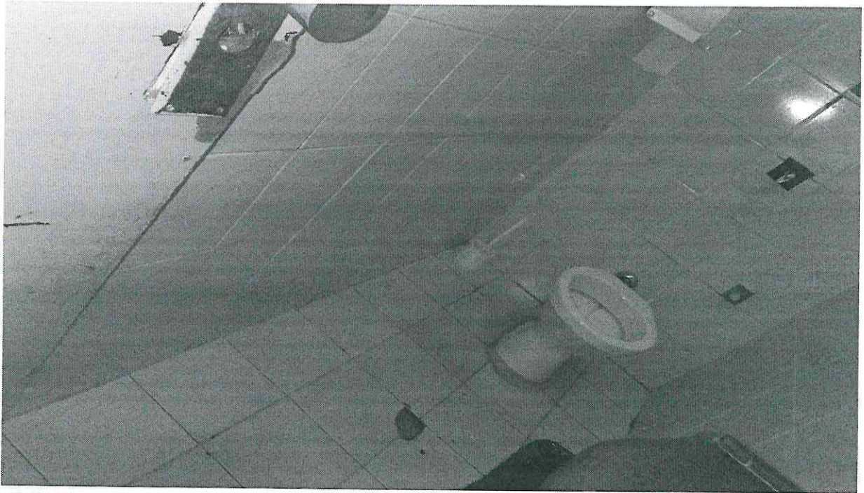
5. Banheiros – cerâmicas e maçanetas danificadas.
