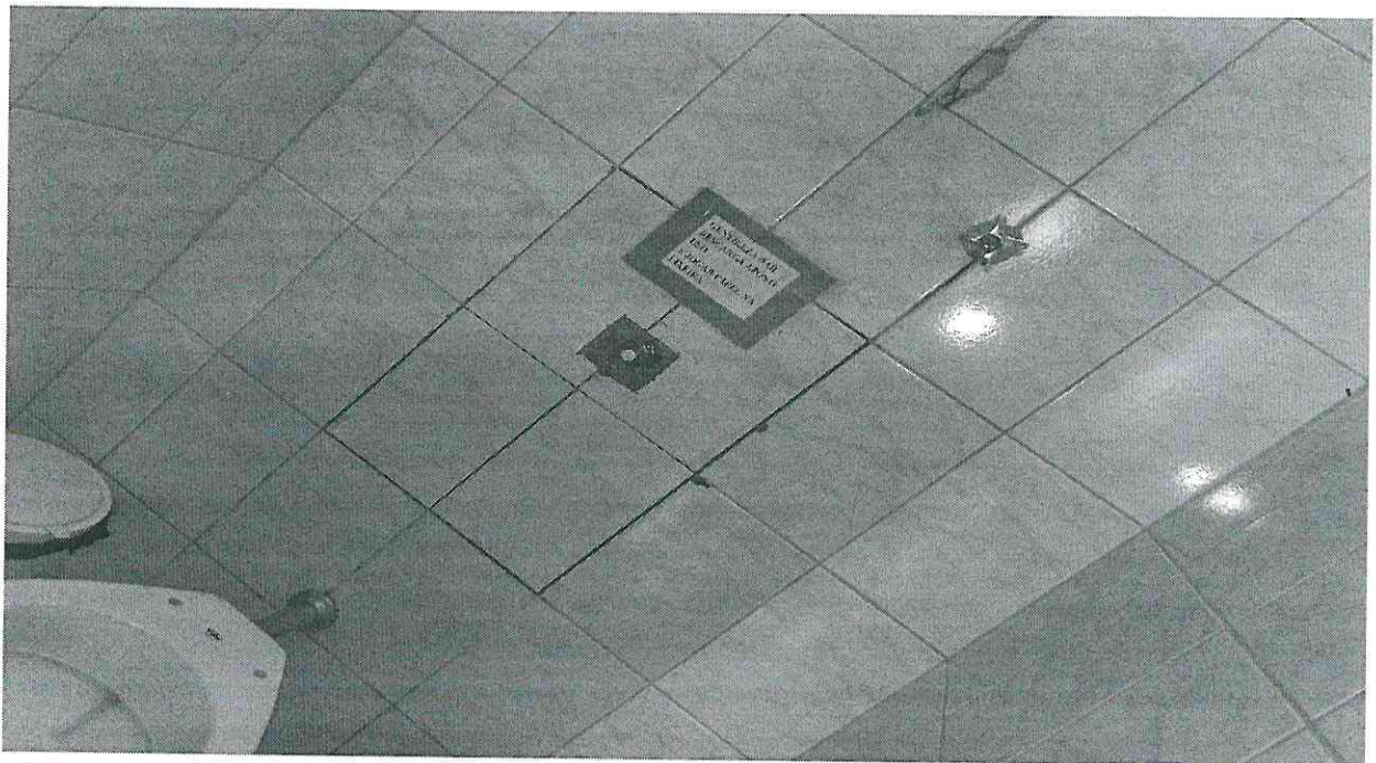
6. Banheiros – sanitários manchados, falta válvula de descarga.
