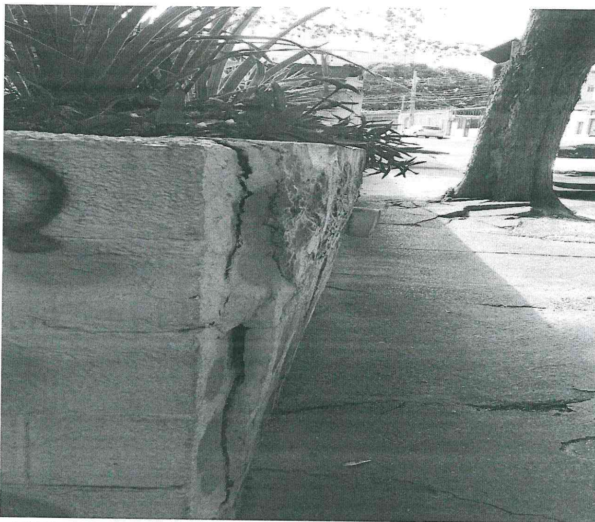
4. Muro de arrimo com tricas e rachaduras.
