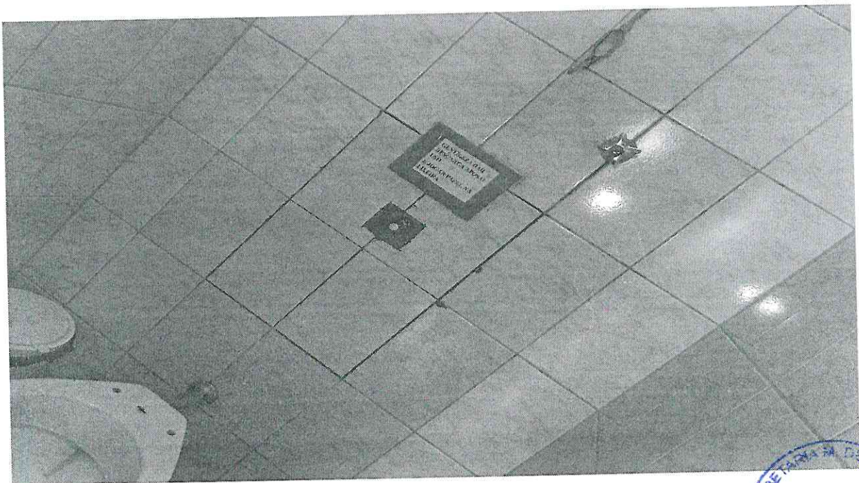
6. Banheiros – sanitários manchados, falta válvula de descarga.
