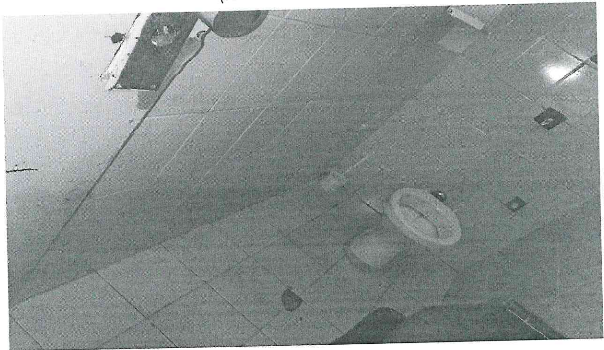
5. Banheiros – cerâmicas e maçanetas danificadas.
