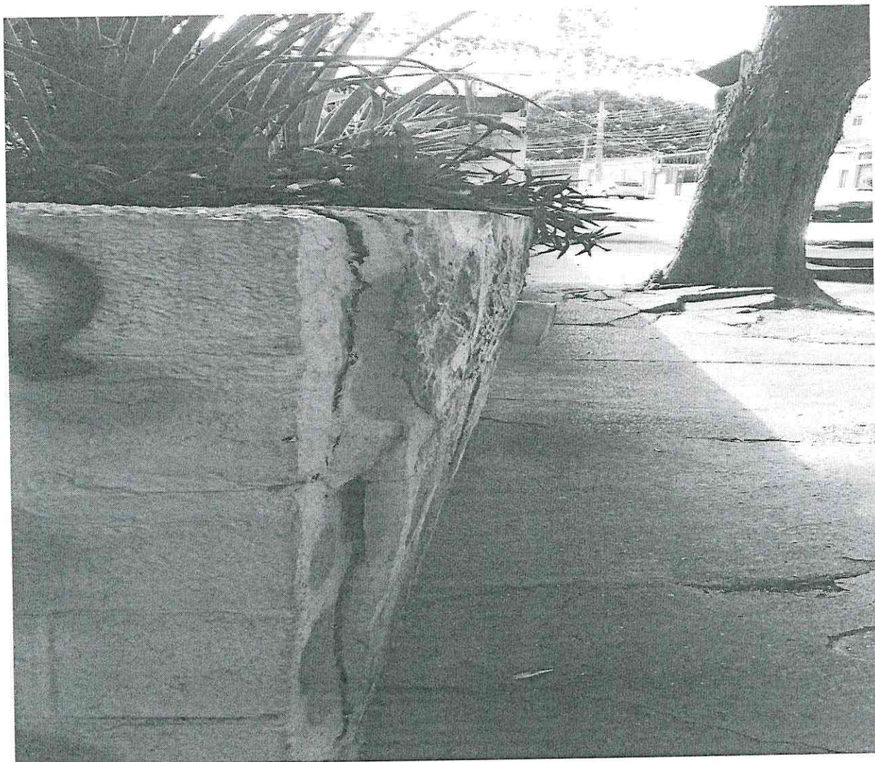
4. Muro de arrimo com trincas e rachaduras.
