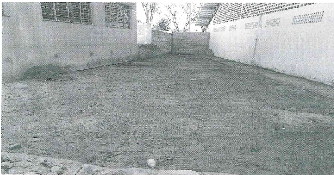
4. Área do parquinho – sem cobertura e piso.
