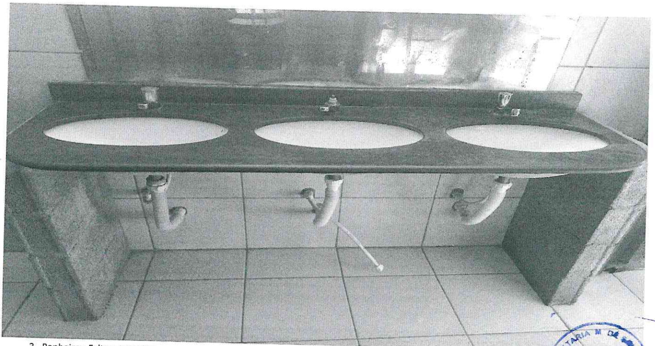
3. Banheiro - Faltam torneiras.
