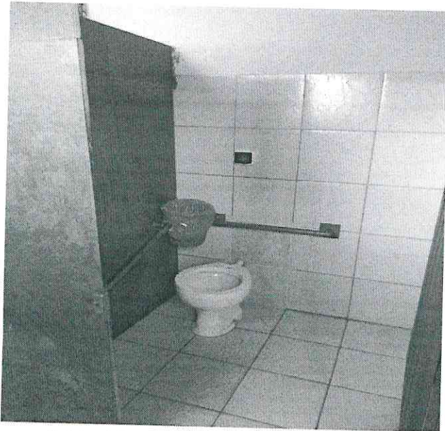
1. Faltando lavatório no banheiro PNE.
