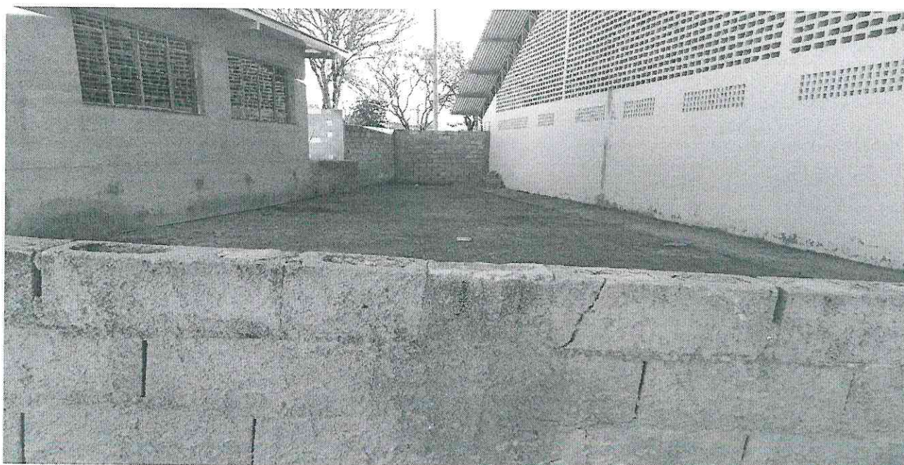
5. Área do parquinho – sem cobertura e piso.
