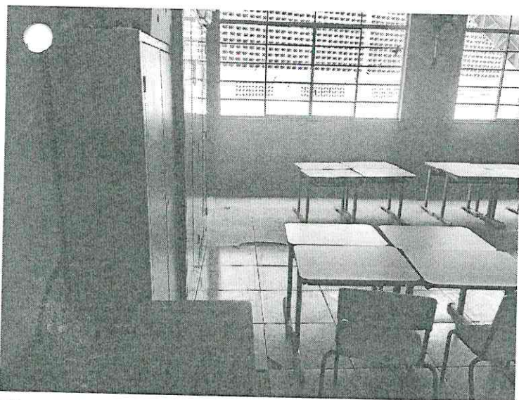
Figura 1: Cerâmica do piso quebrada
