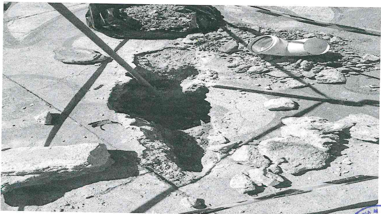
2 Piso do pátio – afundamento e comprometimento do piso de três salas.
