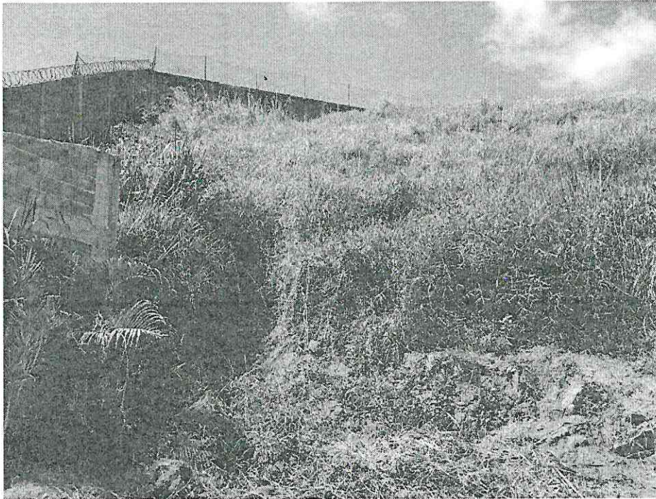
Figura 3: O muro esta comprometido devido a movimentação de terra.
