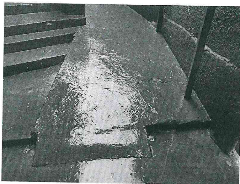
Tamanho de rampa inadequado
