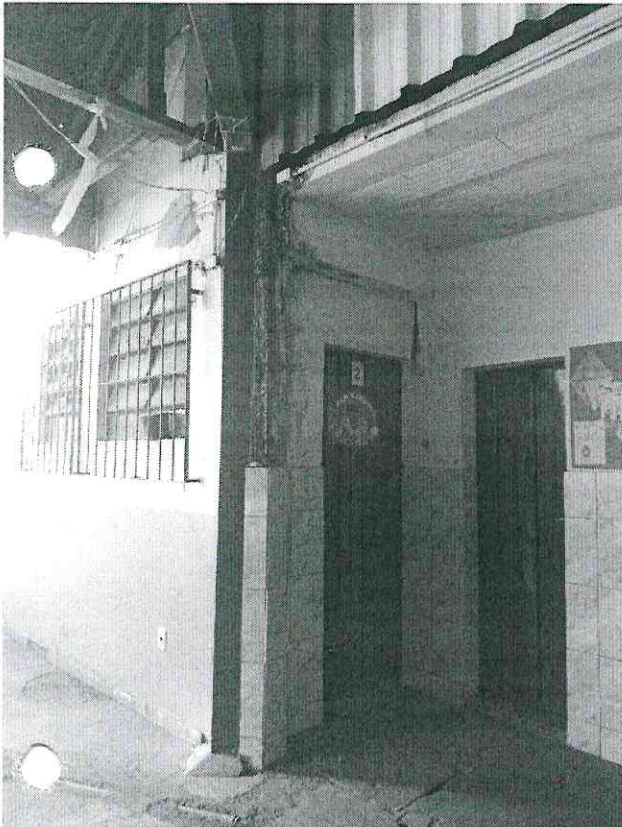
Parede com infiltração devido problema do telhado.
