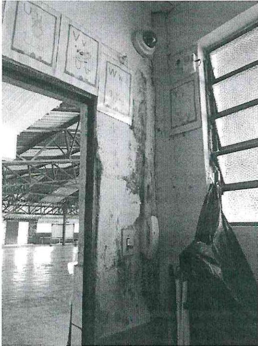
Parede da sala de aula desativada com mofo devido o problema da calha da telhado.
