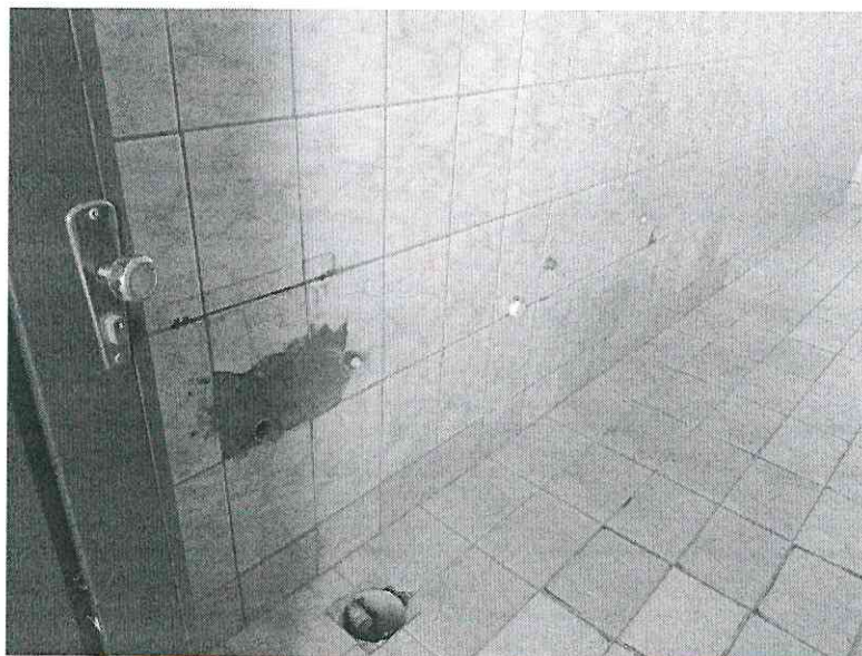
Ausência de lavatórios
