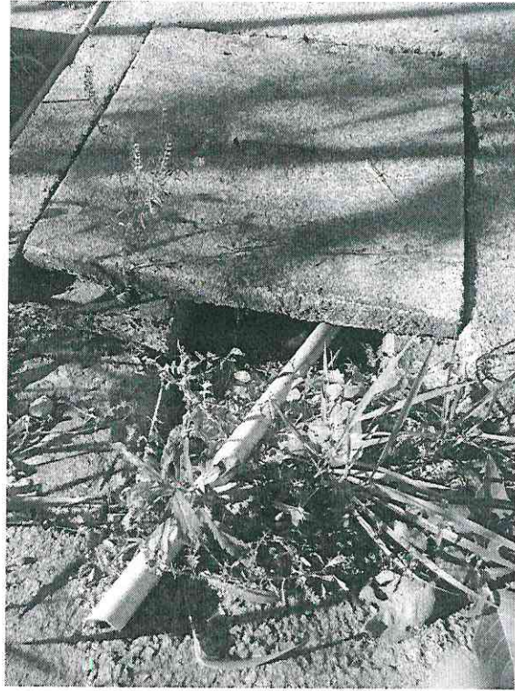
Caixa de esgoto aberto.
