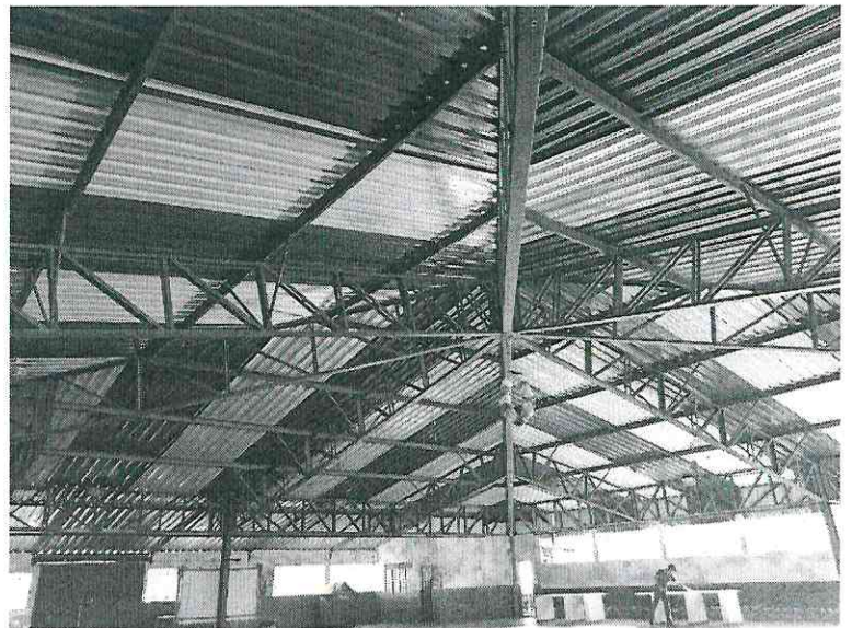
Calha do telhado não suporta ao grande volume da chuva, causando inundação no pátio central impedindo a passagem dos alunos e funcionários da escola.
