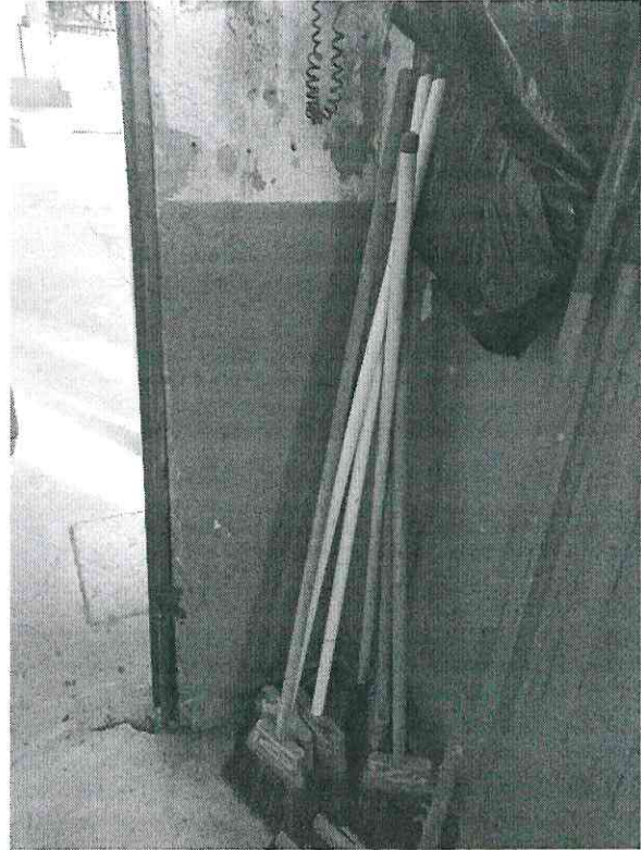
Porta com patologia de ferrugem.
