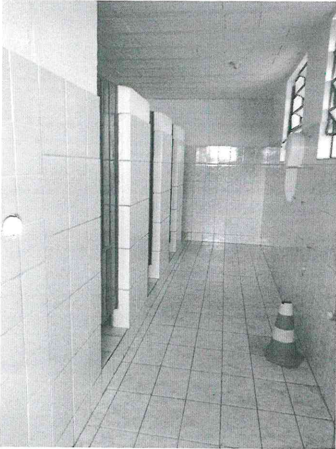
Não possui banheiro PNE
