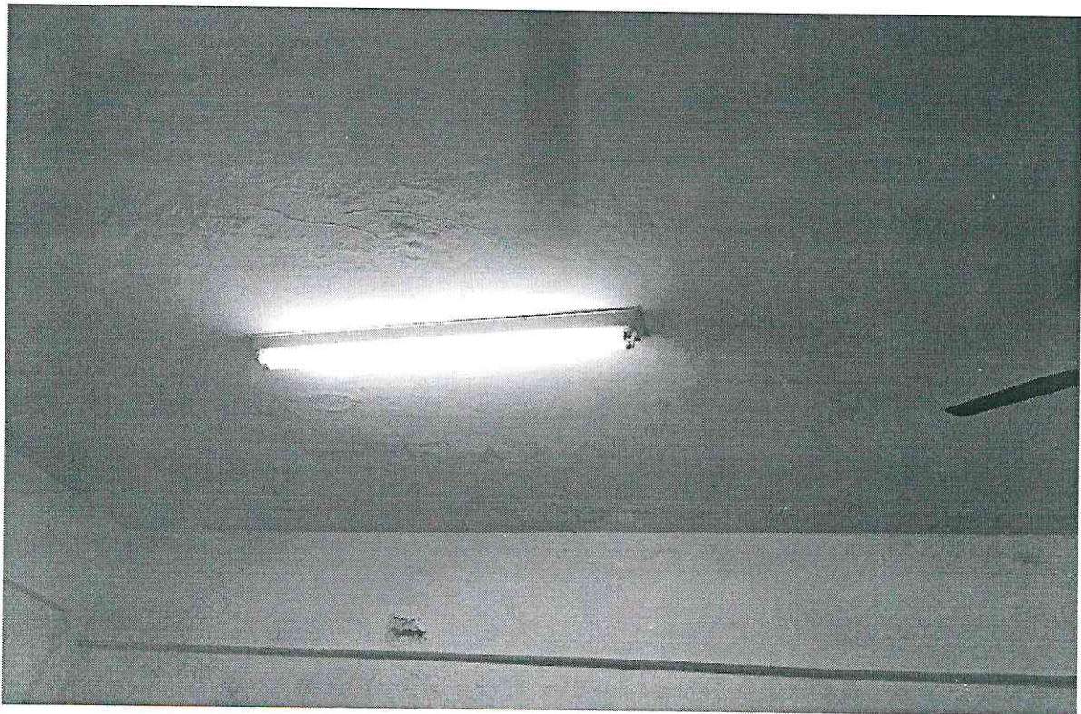
10. Sala de TV - infiltração no teto no entorno da lâmpada.
