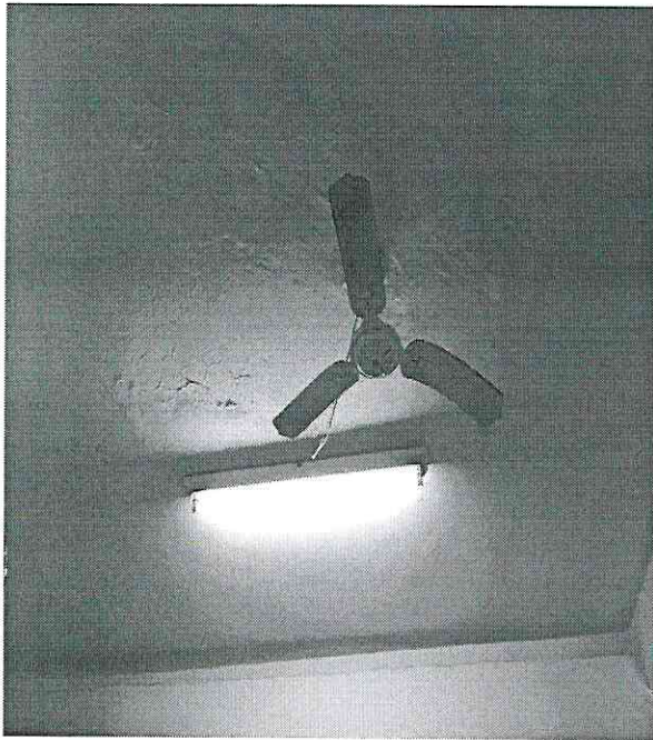
4. Teto do depósito - infiltração prox. a rede elétrica.
