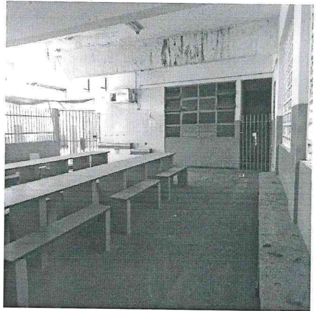
2. Infiltração no teto do refeitório.
