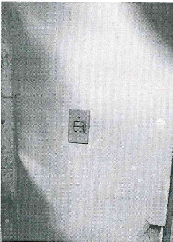
6. Interruptor no depósito, ref. a iluminação da sala de TV.
