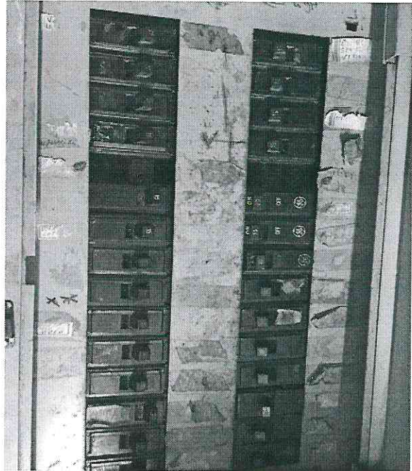
5. Quadro de distribuição de circuitos dentro do depósito.
