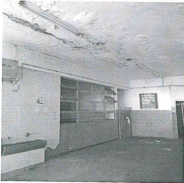
1. Infiltração no teto de refeitório.
