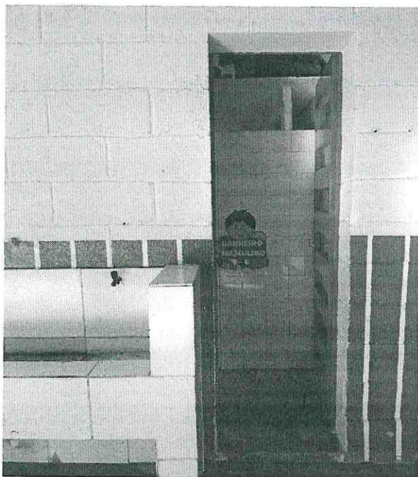
4. Banheiro vão da porta – estreito.
