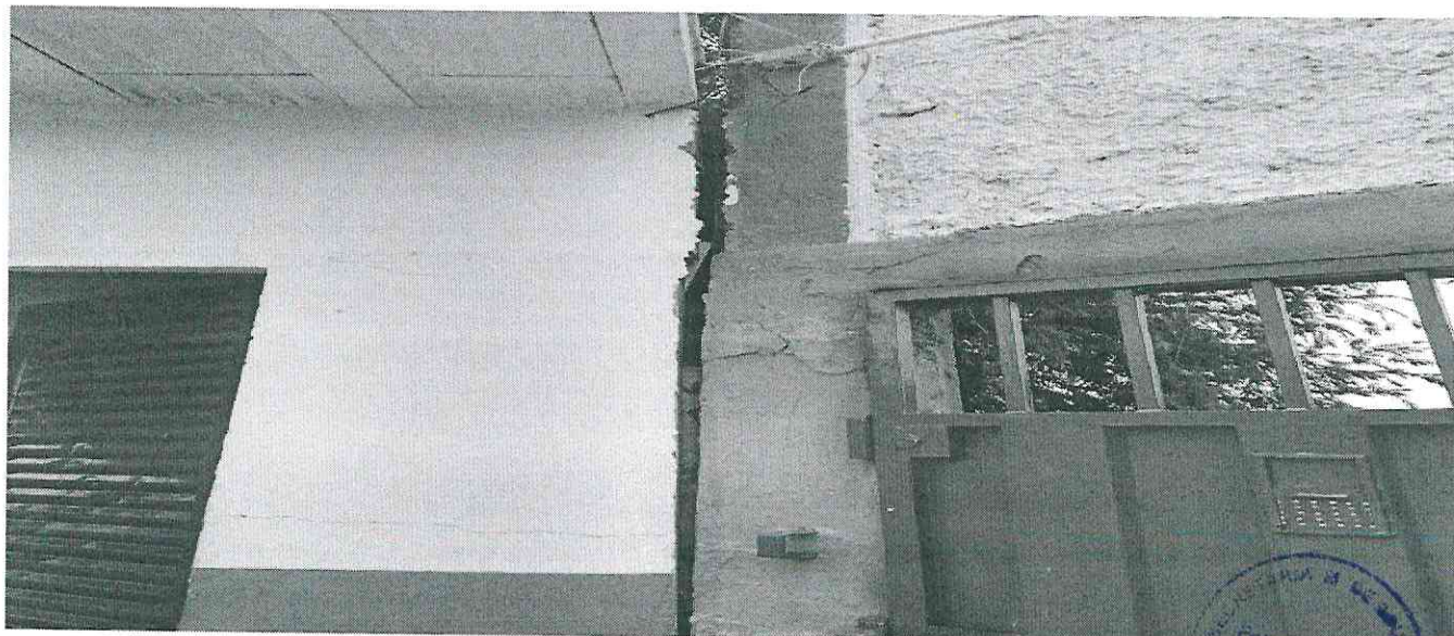
14. Portão – viga de sustentação com rachaduras.
