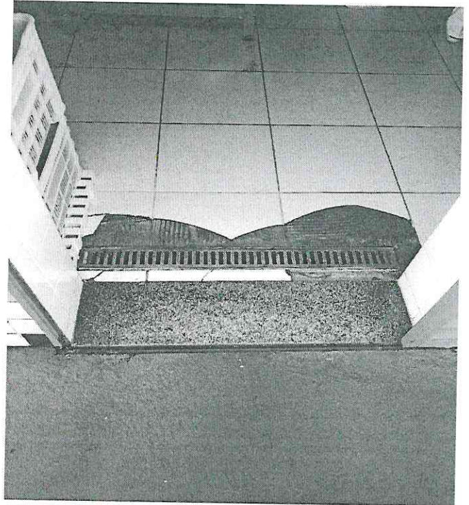
2. Cerâmicas quebradas na entrada da cozinha.
