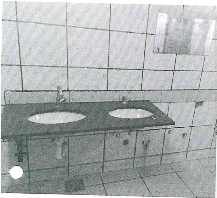
Figura 8: Bancada incompleta, sem torneira e sem sifão. Espelho deteriorado com dimensões insuficiente
