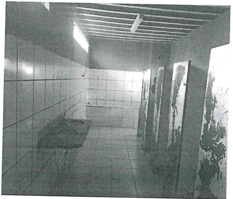
Figura 9: Ausência de porta nas cabines
