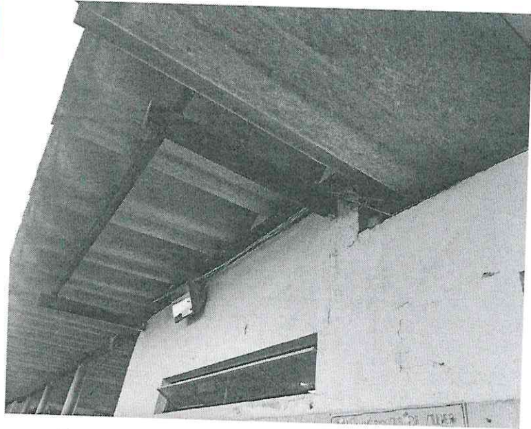
Figura 2: Marca de Infiltração de água pluvial
