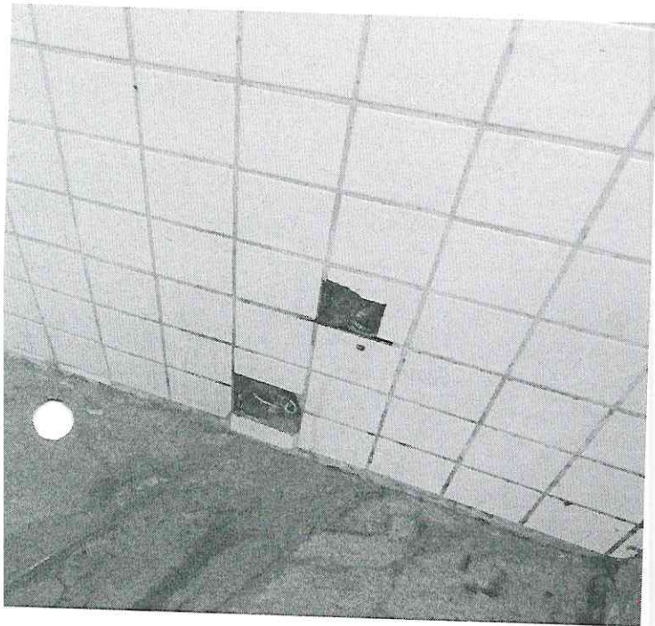
Figura 6: Ausência de tomadas
