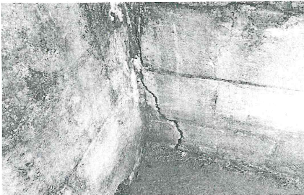
5. Muro com fendas e trincas.
