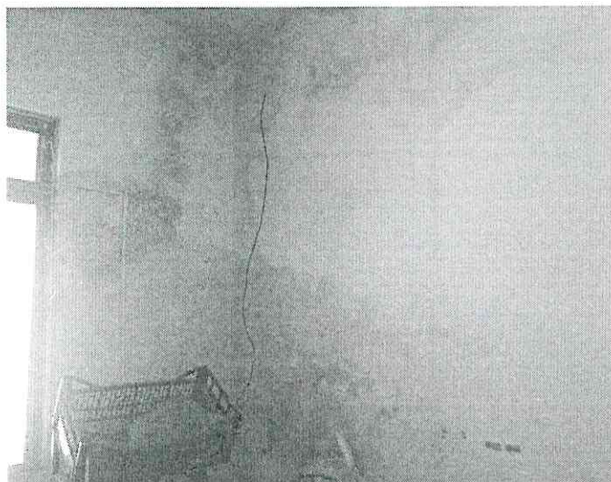
Figura 10: Parede das salas de aula apresentam infiltrações em sua maioria.
